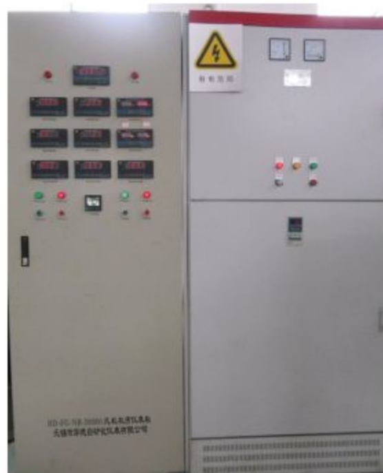
风机变频控制系统
