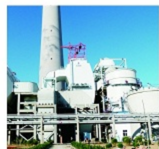
华电淄博热电有限公司#6炉配套 湿式电除尘器综合性能试验
