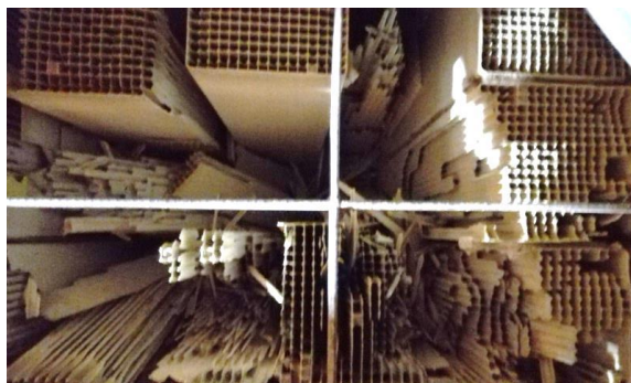
图3 首层催化剂出现严重磨损
